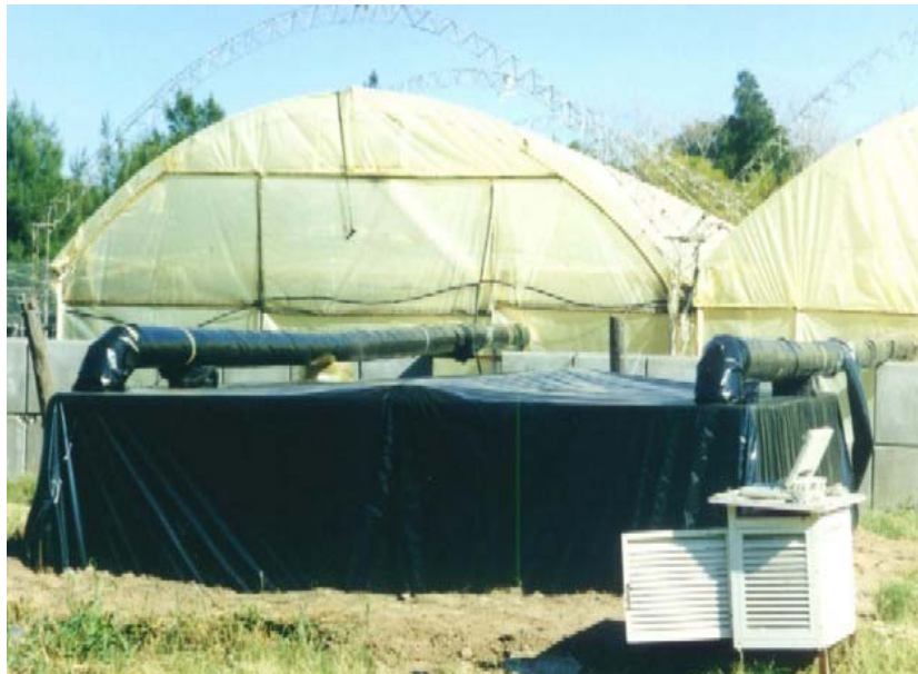
Figura 9. Vista del acumulador de calor con lecho de piedra. Caloductos entre las dos cubiertas. Conductos de aspiración e impulsión.
